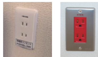
非常用コンセント
